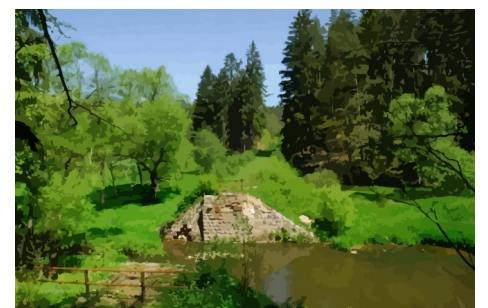
Zerstörte Thayatalbahn-Brücke über den Feinitzbach
